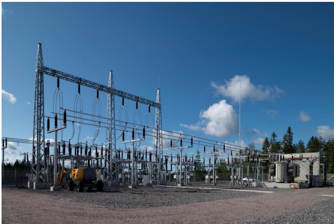
Kuva 5-5. Esimerkki tuulivoimahankkeen sähköasemasta. © Ilmatar Energy Oy.
